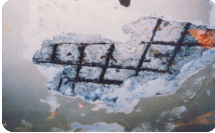
الشكل (2- b) : التآكل
