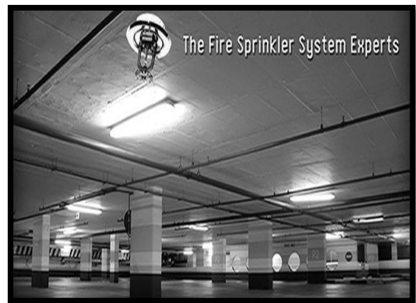
صورة 35-5 توضح شبكة رشاشات حريق معلقة بالسقف
