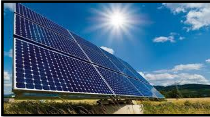
صورة 5-20 توضح ألواح شمسية
