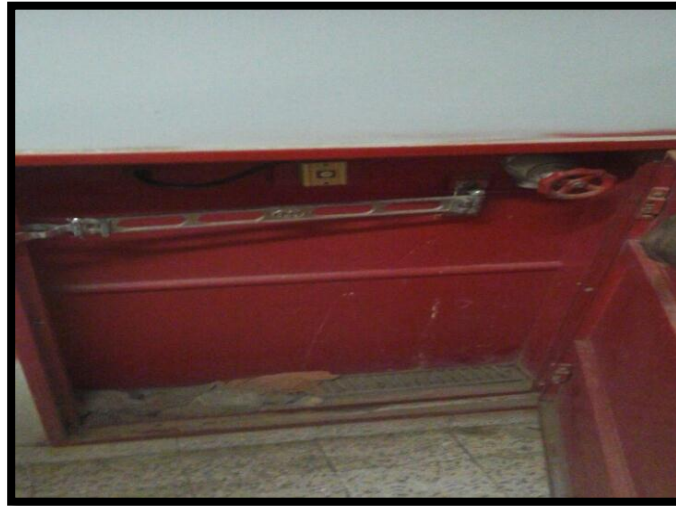
(شكل 39.5 النظام المعطل للحريق)
