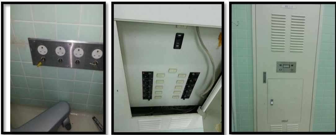
(شكل 16.5 لوحة التحكم في كهرباء غرف العمليات ومقابس التوصيلات الكهربائية)
