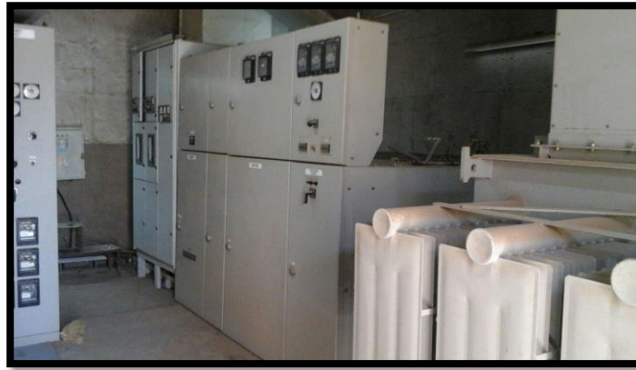
(شكل 5.30 غرفة الكهريا)
