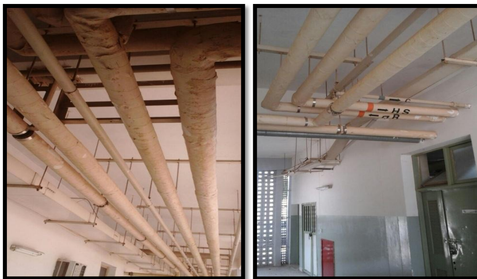
(شكل 15.5 صورة توضح وصلات البخار والمياة الصالحة للاستخدام)
