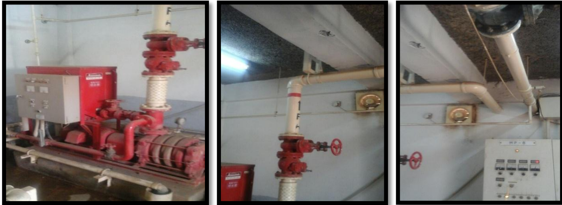
(شكل 31.5 المحطة الرئيسية للمياه)
