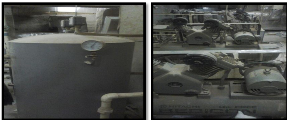
(شكل 41.5 منطقة غاز النيتروجين)
