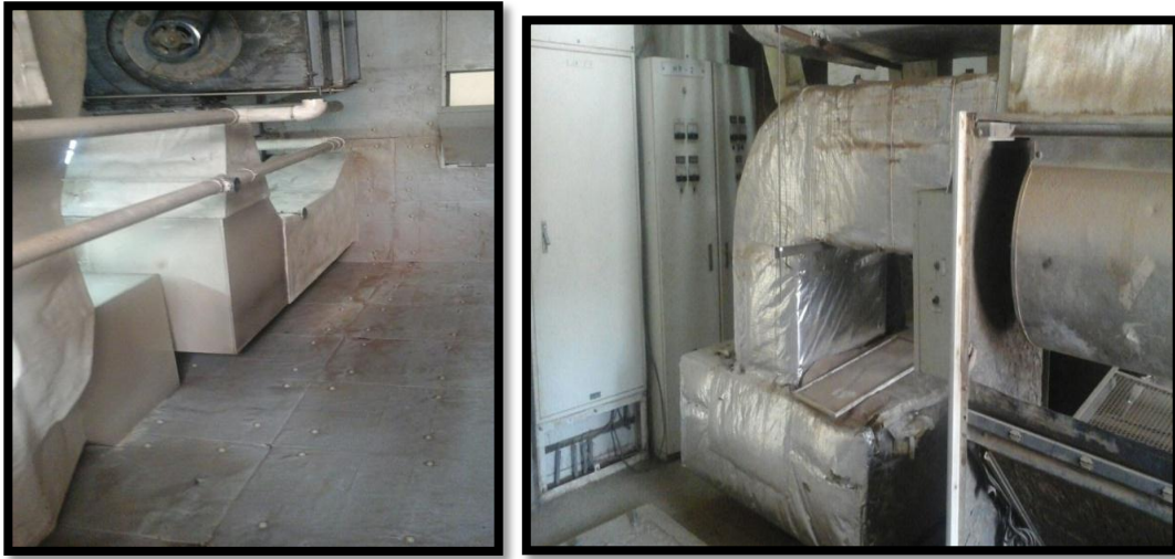
(شكل 37.5 غرفة التكييف المركزي)
