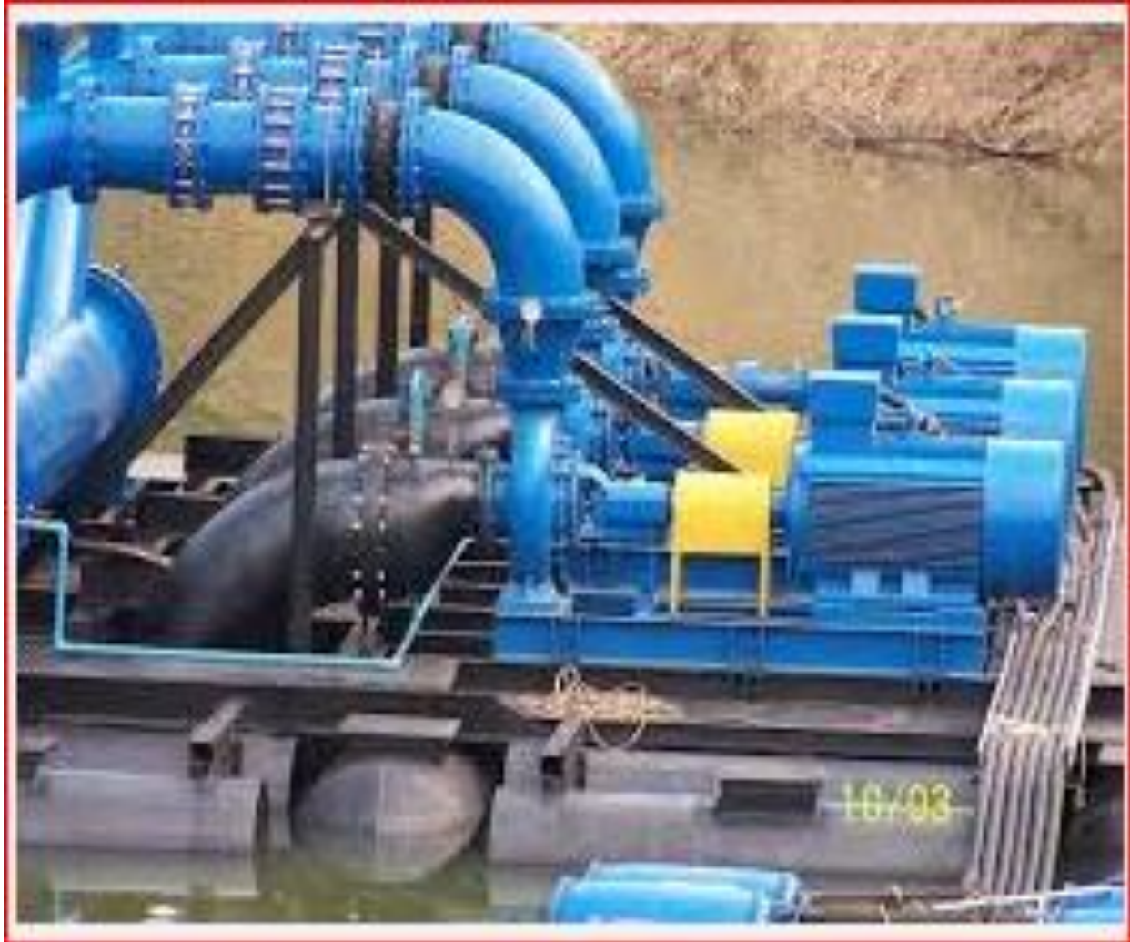
ظلمبات الضخ العالي في محطة المعالجة للمياه
