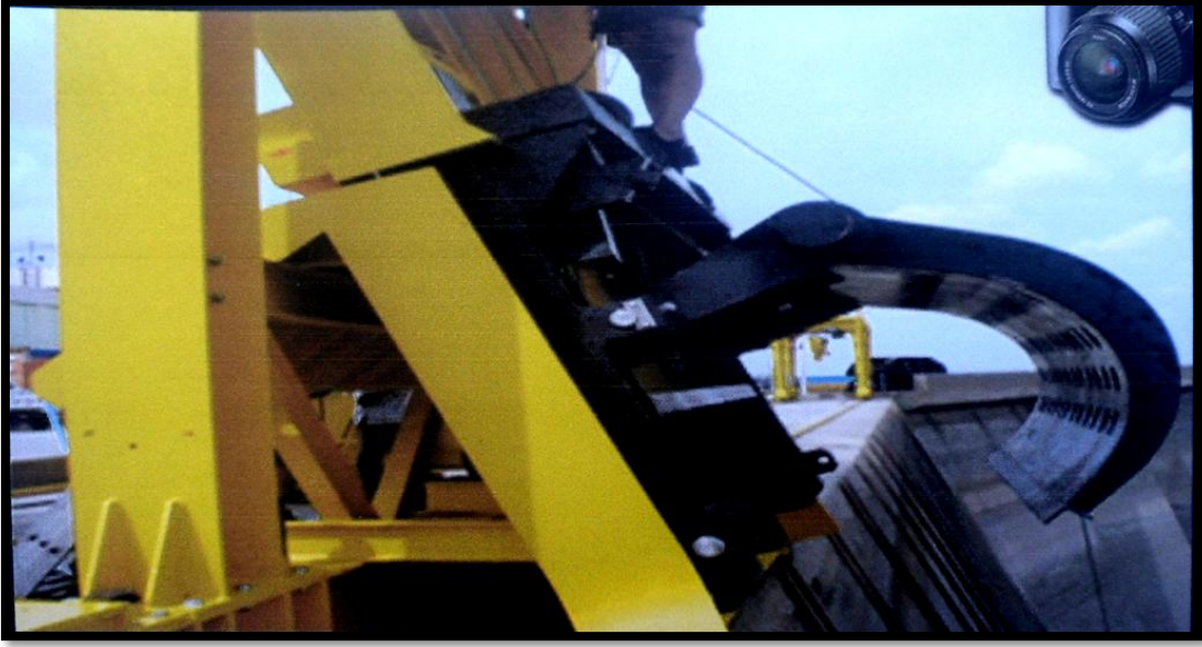
صورة (7) : The Trash Rack Rake
