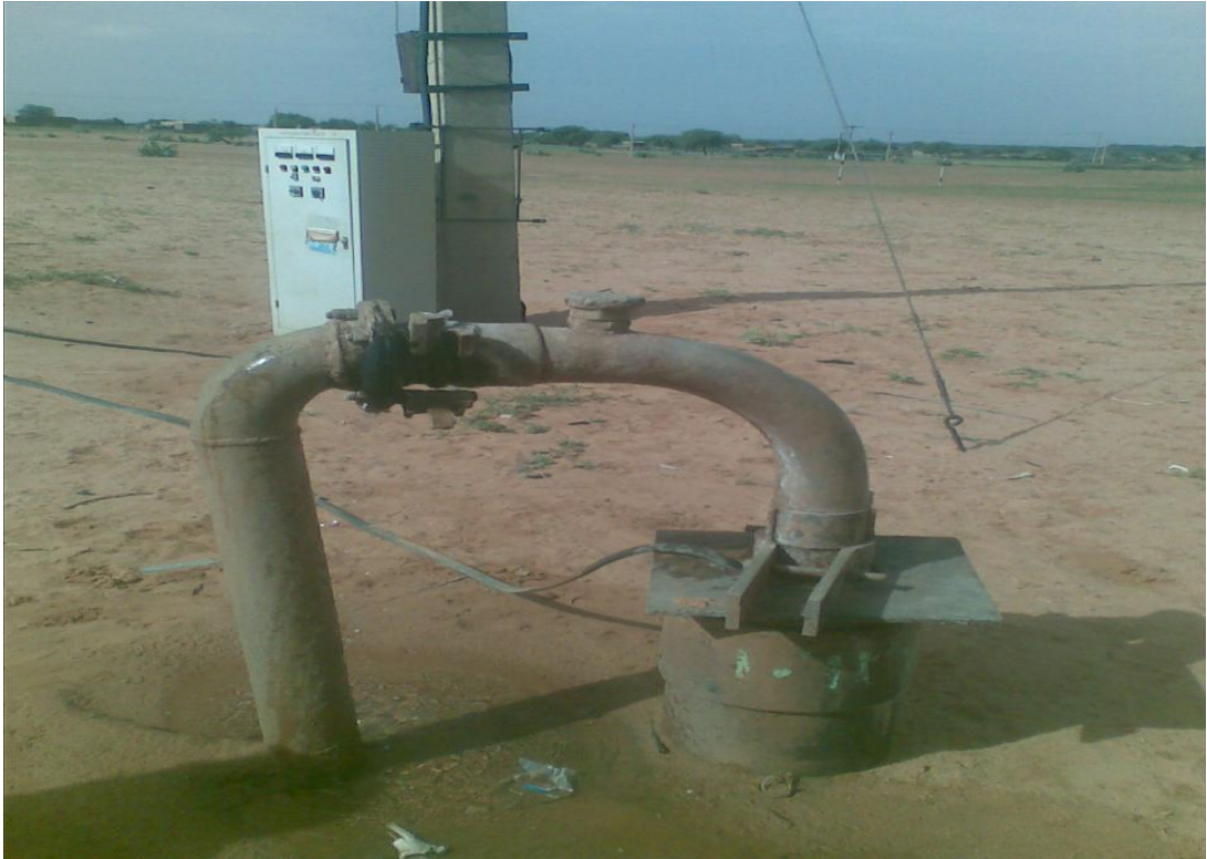
ملحق (8): الينر ولوحة التحكم الكهربائي (المفتاح الكهربائي) بمنطقة شقرة
