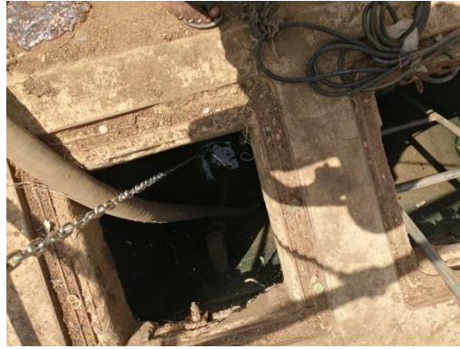
صورة (4-5) : خزانات تجميع مياه الصرف الصحي
