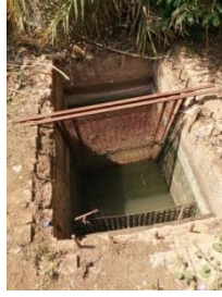
صورة (4-4) : مصفى مياه الصرف الصحي
