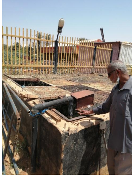
صورة (4-13) : حوض تجميع المياه المعالجة
