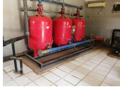
صورة (4-10) : مرشحات المياه
