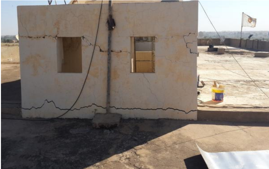
الشكل (3.8) التصدعات عند فواصل الحركة بين وحدات المبنى من الجهة الغربية.
