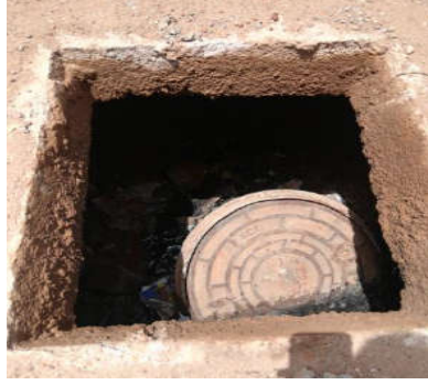
شكل (3-16) صورة توضح اغطية احواض التحليل المفتوحة بمجمع ابراج الشرطة (شمبات).
