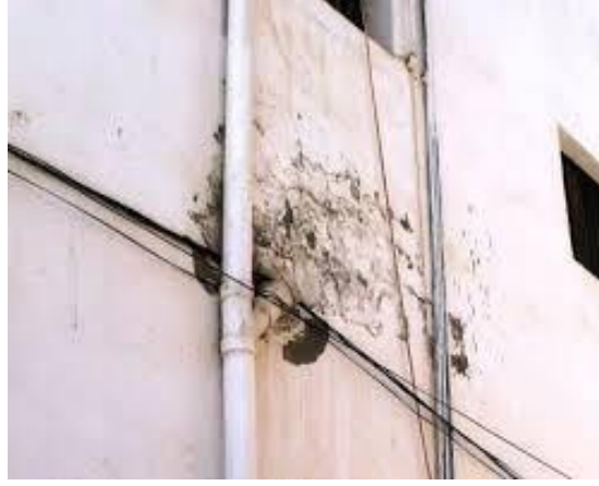
الشكل رقم (3-7)- تأثير المياه على الواجهات
