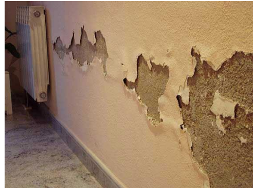
الشكل رقم (3-6) -مشاكل البياض الداخلي
