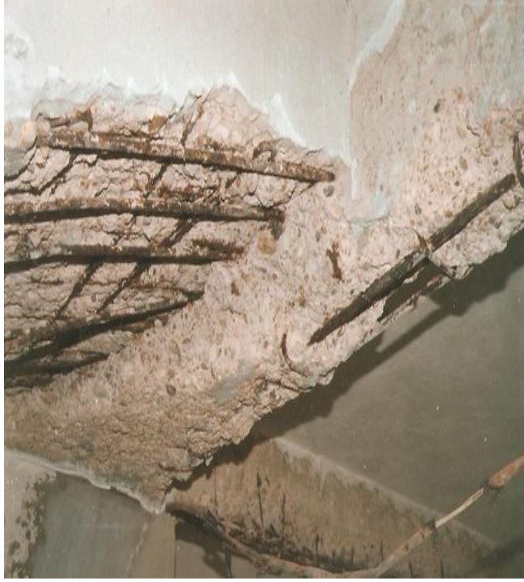
الشكل رقم (3-15) (مشاكل المباني الخرسانية)
