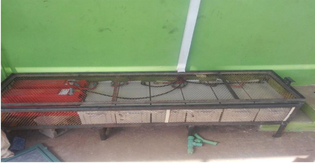
الشكل 5-9 بطاريات تخزين الكهرباء المصدر (الباحث، 2018)
