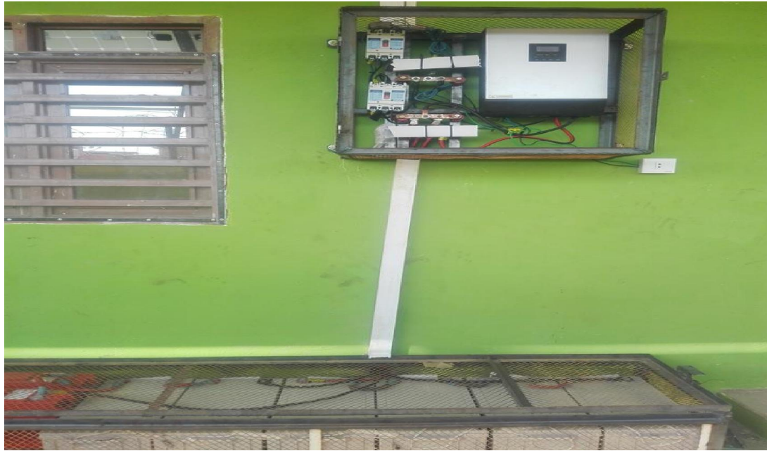
الشكل 5-8 توصيل الطبلون بالبطاريات المصدر (الباحث، 2018)
