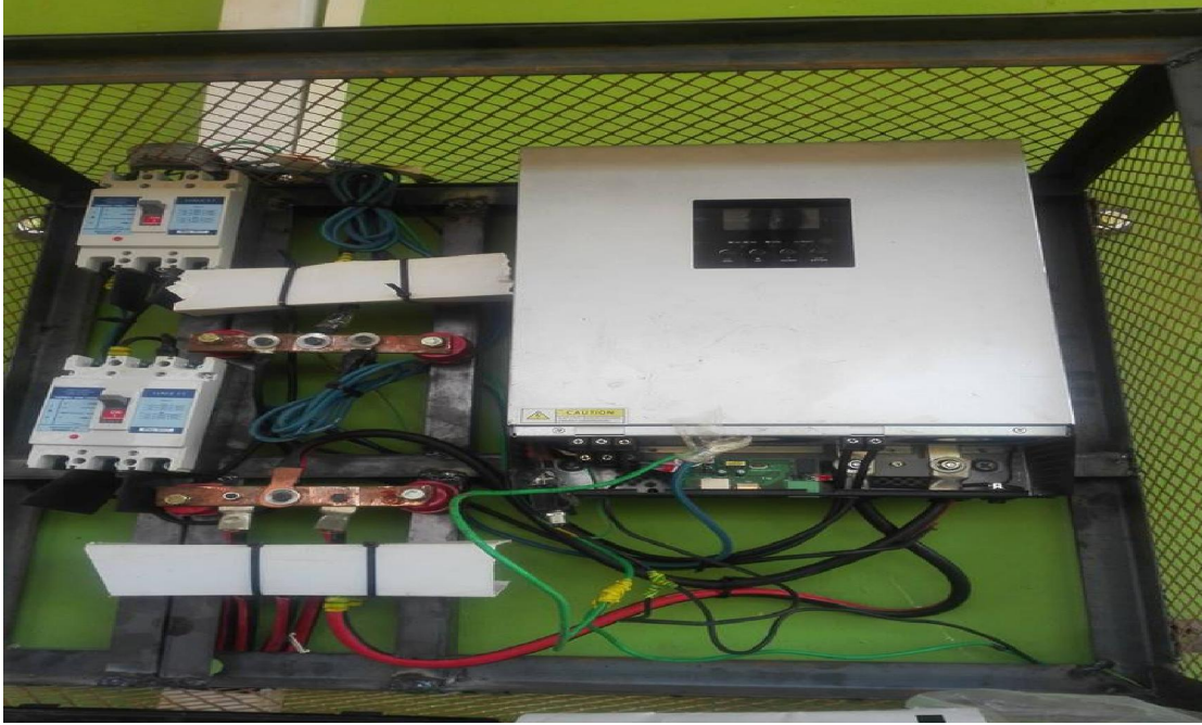
الشكل 5-7 جانب من منظومة الطاقة الشمسيه بالمبنى المصدر (الباحث، 2018)
