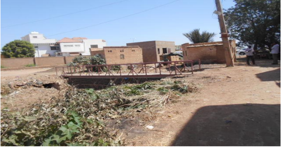
صورة ( 12.3 ) توضح محطة رفع (2) نهاية مصرف الكلس
