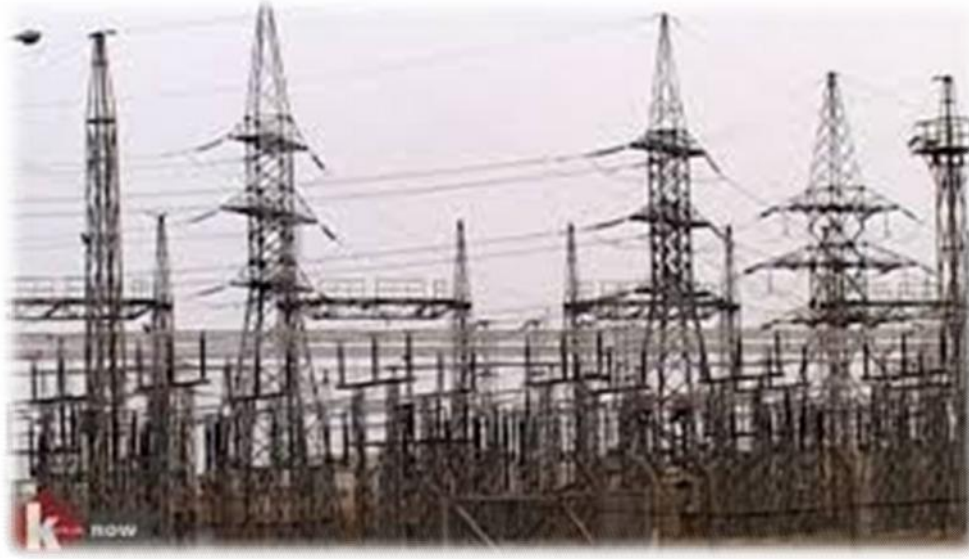
محطة توزيع الكهرباء
