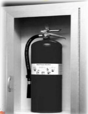
الصورة 35 توضح الطفايات اليدويه
