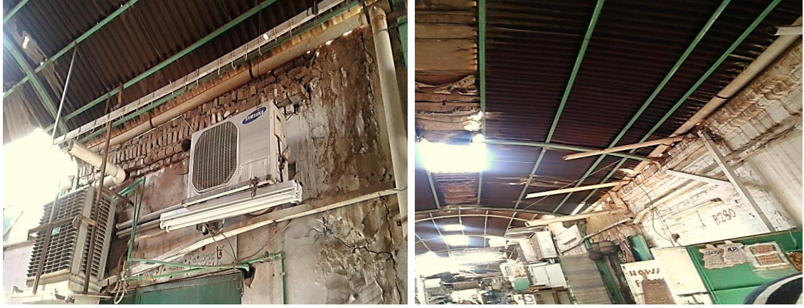
صورة رقم ( 3-31) توضح سوء تمديدات الكهرباء و التكيف
