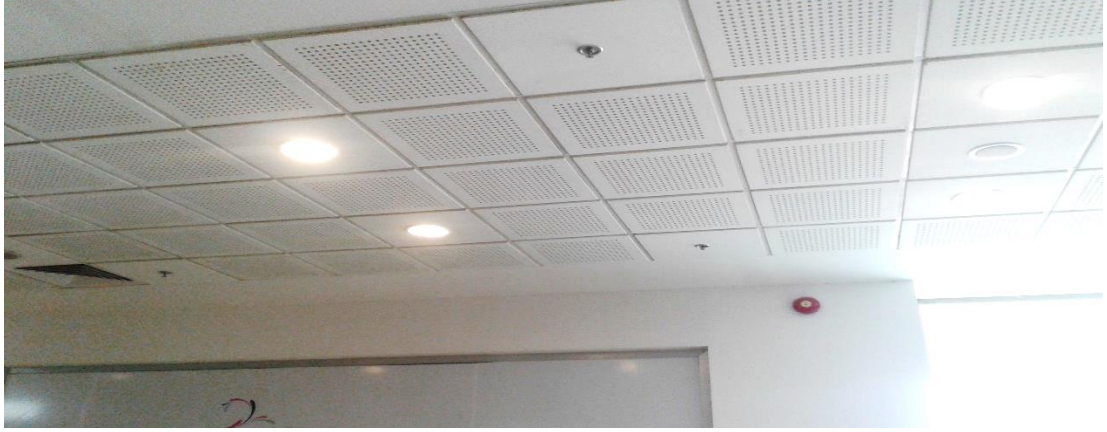
صورة رقم (3-12) توضح الرشاشات المستخدمة لإطفاء الحريق
