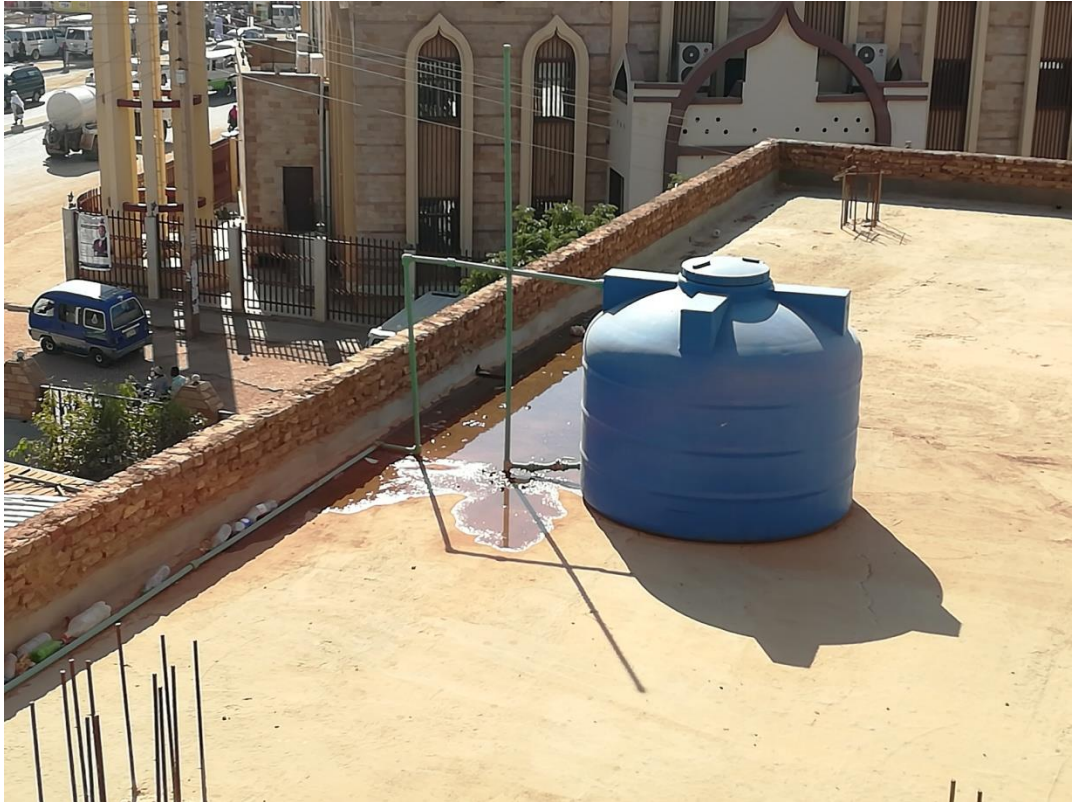
شكل رقم (4-5) تسرب المياه من الخزانات داخل المبنى، المصدر الباحث
