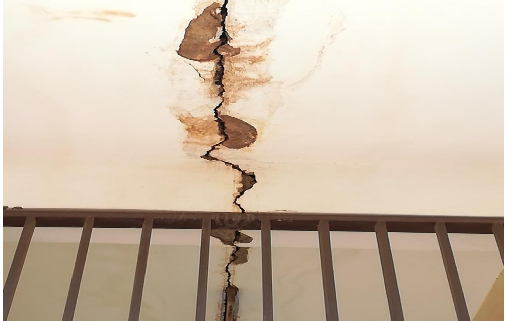
شكل رقم(4-11) شق في سقف الطابق العلوي بكلية الدراسات الاقتصادية والاجتماعية،المصدر الباحث
