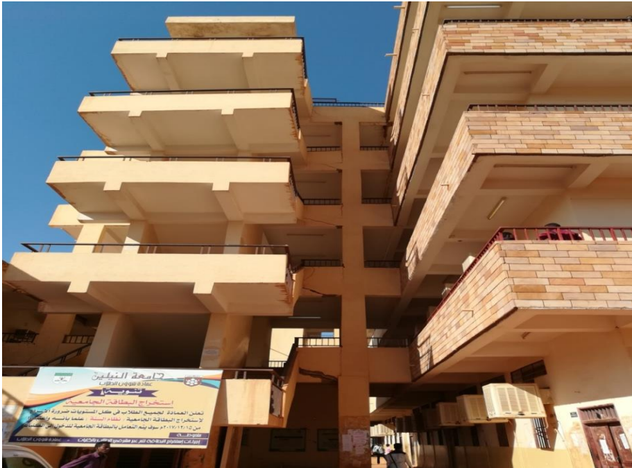
شكل رقم (3-4) مبنى كلية الدراسات الاقتصادية بمنطقة كلية الدراسات الاقتصادية والاجتماعية (المنظر العام)،المصدر الباحث
