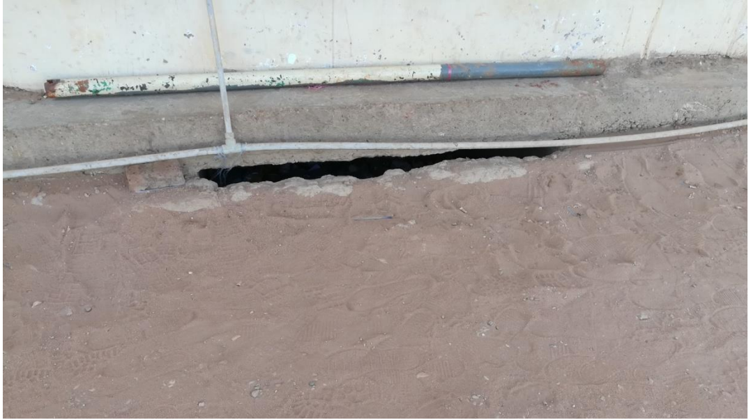
شكل رقم (4-6) فتحات في المبنى نتيجة لتسرب المياه، المصدر الباحث
