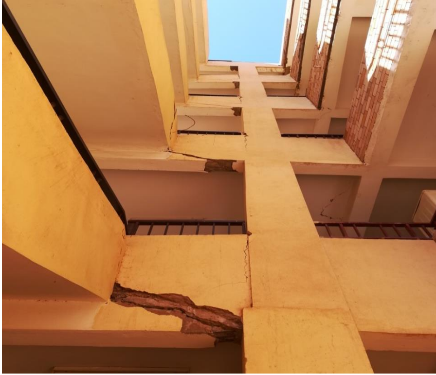
شكل (4-4) يوضح التشققات بسبب هبوط المبنى، المصدر: الباحث
