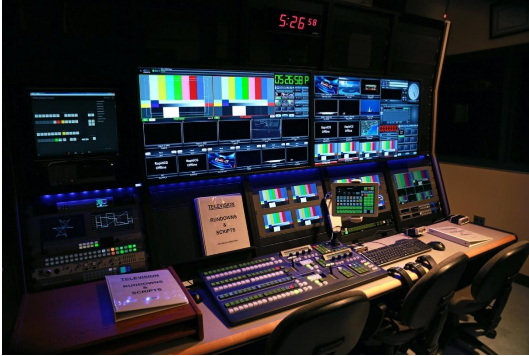
شكل (25) وحدات غرفة التحكم
