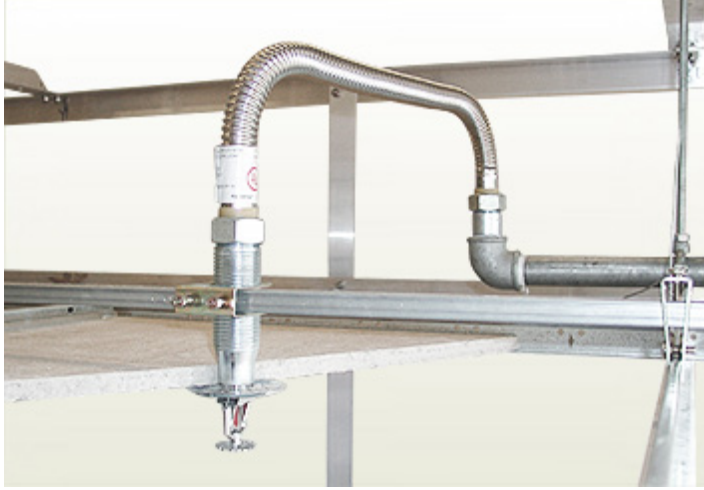
صورة 5-30 رشاش حريق
