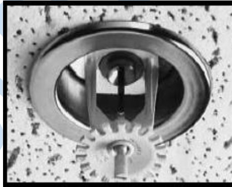
صوره (85) توضح رشاشة الحريق
