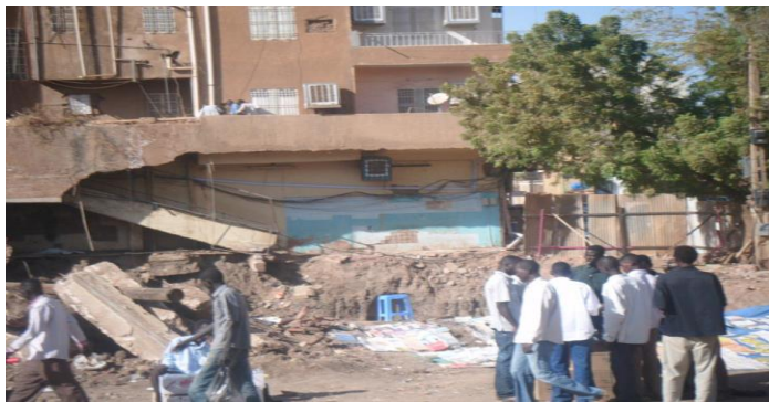
صورة رقم (31-3) توضح عدم إزالة الأبنية الخربة و الآيلة للسقوط – المصدر الباحث
