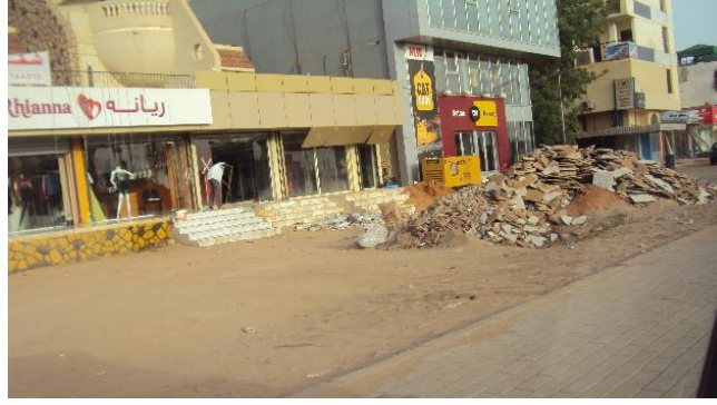
صورة رقم (3-32) توضح عدم إزالة مخلفات البناء – المصدر الباحث
