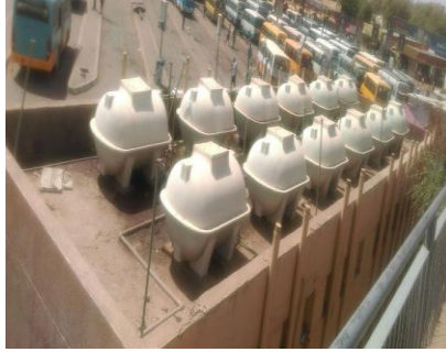
صورة رقم ( 3-27) توضح الاستغلال الخاطئ لأسطح المباني - المصدر:الباحث
