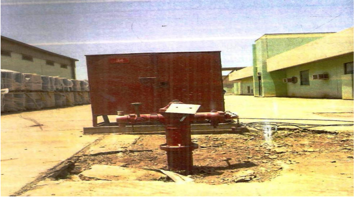
شكل (2-3) يوضح حنفية حريق وصندوق بداخله خرطوم
