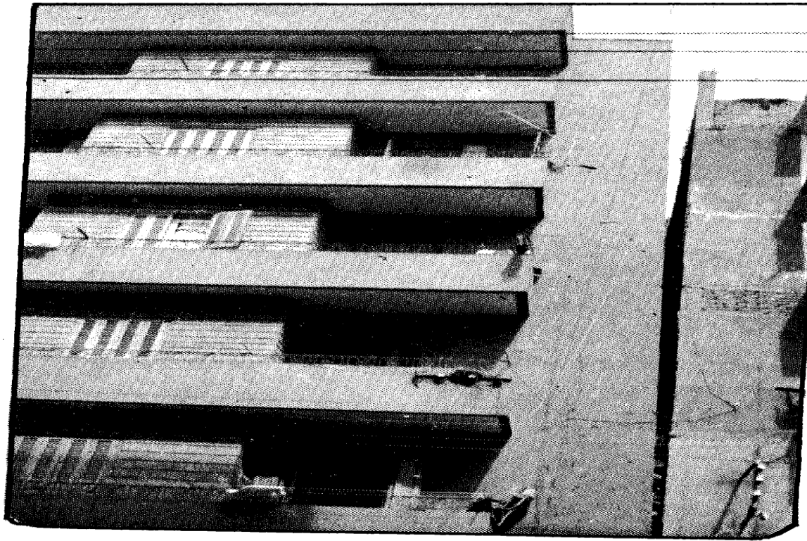
شكل (15-2) ميل في المبنى الايمن نتيجة هبوط الاساسات
