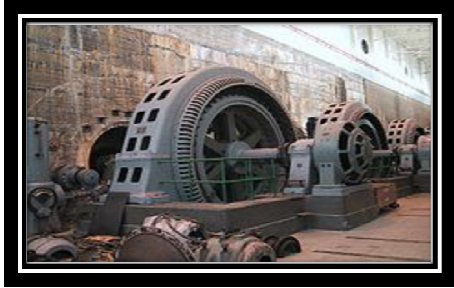
شكل (3.2) يوضح المولد الكهربائي
