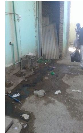
صورة (4-82): توصيلات الشبكة
