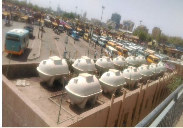
صورة رقم (3-33) توضح الإستغلال الخاطئ لأسطح المباني بميدان جاكسون المصدر:الباحث
