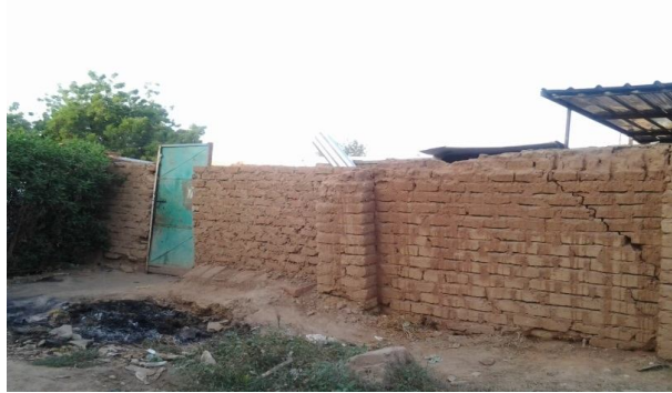
صورة رقم (3-7) توضح تردي واجهات المباني بسبب عدم الصيانة بمدينة الخرطوم
