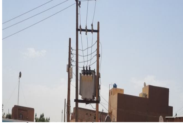
صورة رقم (2-3) توضح تشابك أسلاك الكهرباء بمدينة الخرطوم المصدر:الباحث
