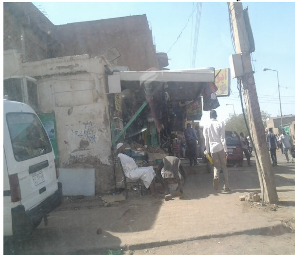
صورة رقم (31-3) توضح عدم ترميم المباني القديمة بميدان جاكسون المصدر: الباحث
