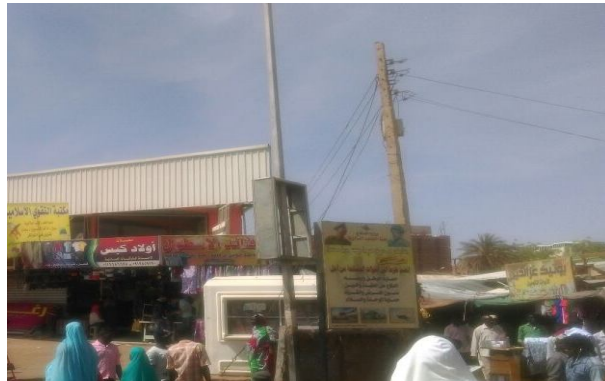
صورة رقم (3-34) توضح تشابك أسلاك أعمدة الكهرباء بميدان جاكسون المصدر:الباحث
