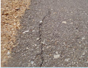
Fig. A.19: Low Severity Edge Cracking
