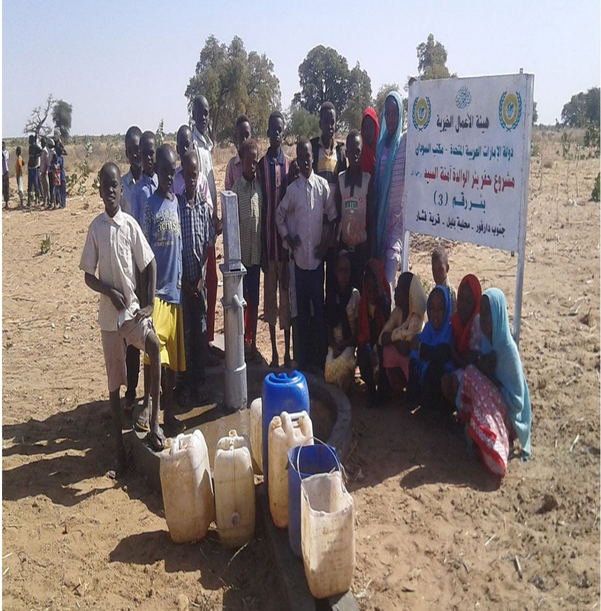
صورة لأنشطة منظمة هيئة الأعمال الخيرية بحفر وتركيب مضخة مياه يدوية بقرية فشار بمحلية بليل - ولاية جنوب دارفور المصدر : منظمة هيئة الاعمال الخيرية - مكتب نيالا - جنوب دارفور
