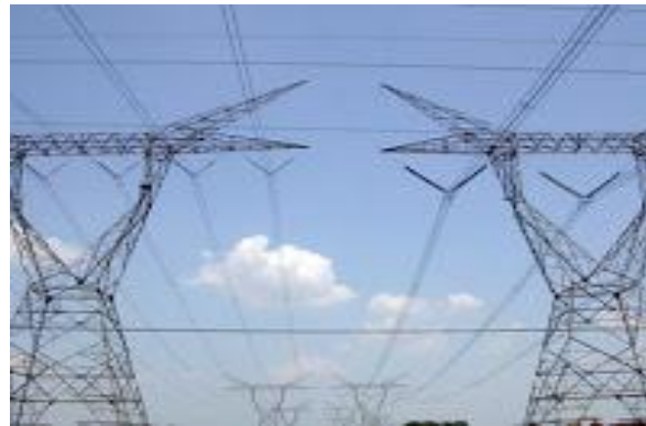
شكل رقم (2-2) مرحلة نقل الكهرباء (4).
