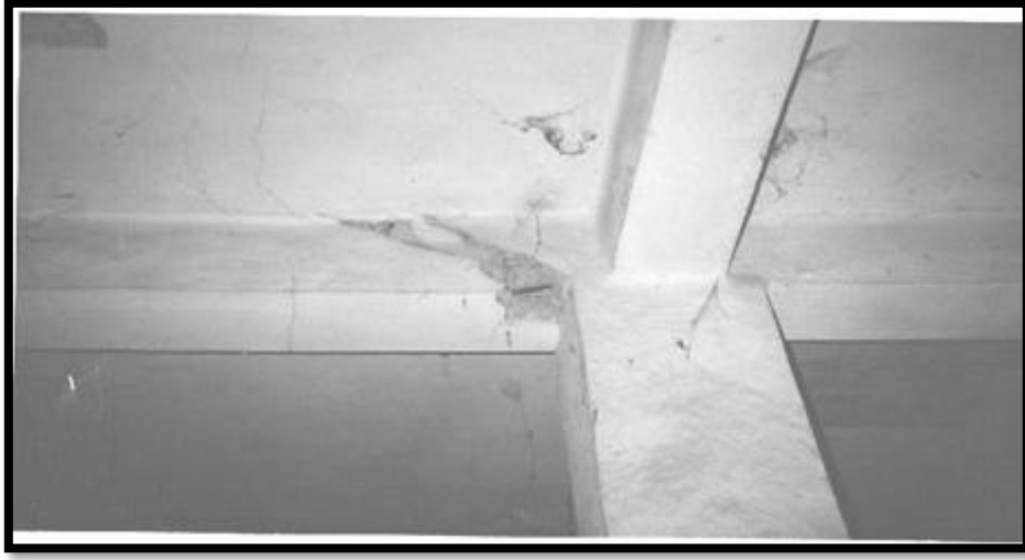
شكل ( ٢ - ٢٦ ) شروخ نتيجة زيادة إجهادات القص
