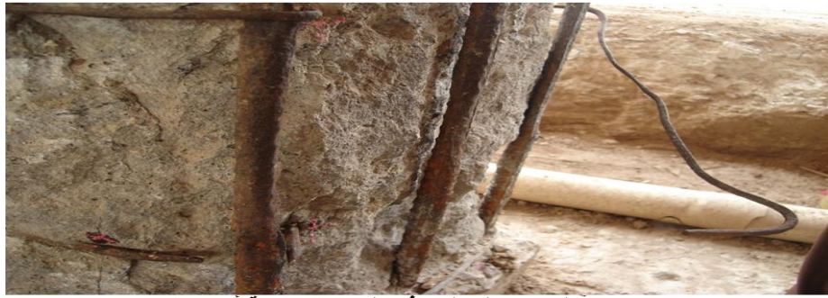
تآكل حديد التسليح في الدعامات جهة أم درمان
