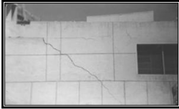
شكل ( ٢ - ٥١ ) شرخ في حائط نتيجة حدوث فرق في الهبوط
