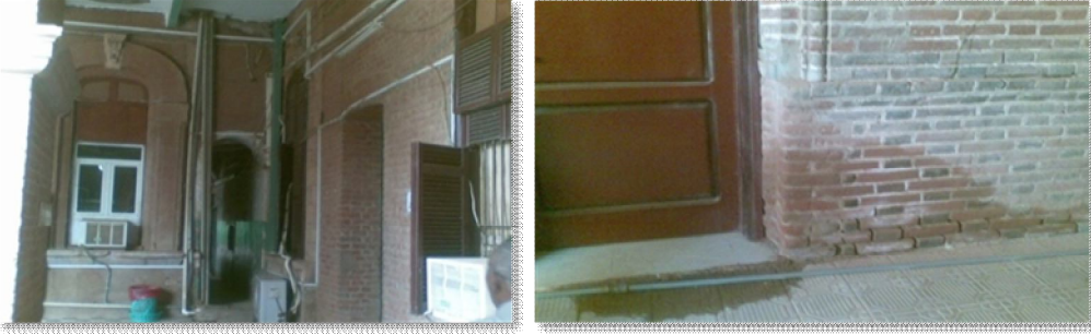
تأثير توصيلات مواسير المياه على المبنى
