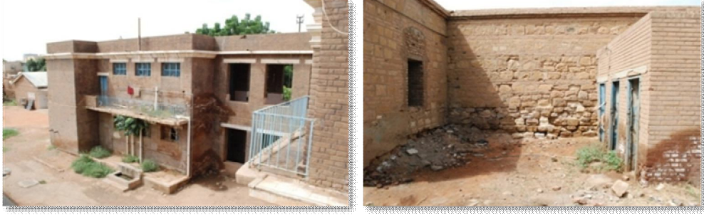
شكل (٥٧-٨) تأثير مياه الصرف الصحي والرطوبة على جدران المستشفى المصدر: الإدارة العامة للآثار والمتاحف
