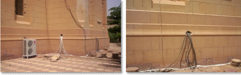
إنشاء توصيلات للمبنى بصورة عشوائية-المصدر: الإدارة العامة للآثار والمتاحف، ٢٠١٢م شكل (٨-٦٠) التشوهات في مسجد فاروق (أرباب العقائد)
