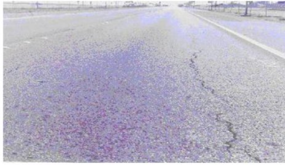
شكل رقم (1-2) يوضح شدة منخفضة للشقوق التماسحية
