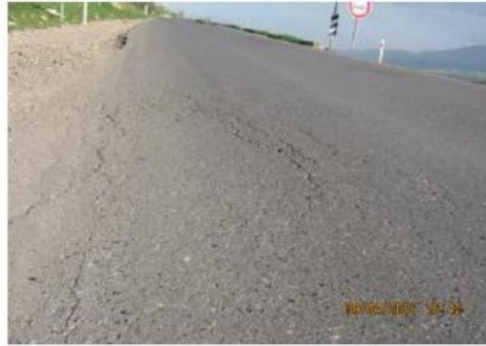
شكل رقم(2-10) يوضح شدة منخفضة للشقوق الجانبية
