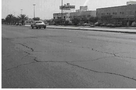
شكل رقم (2-4) يوضح شدة منخفضة للشقوق الشبكية
