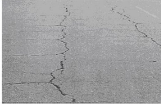
شكل رقم (2-5) يوضح شدة متوسطة للشقوق الشبكي
