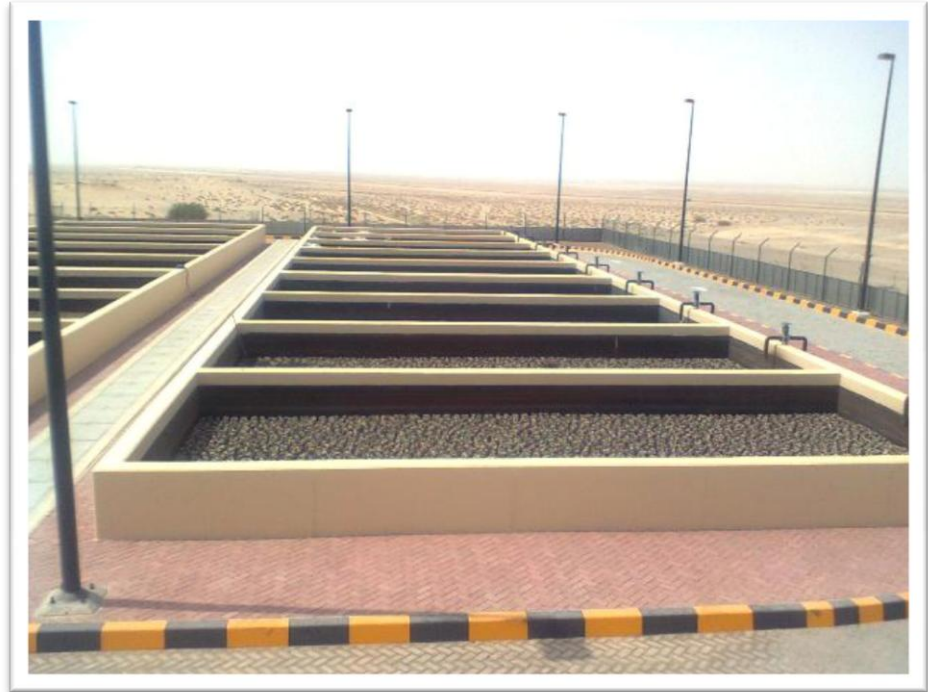
شكل رقم (14) يوضح أحواض تجفيف الحمأة بأشعة الشمس
