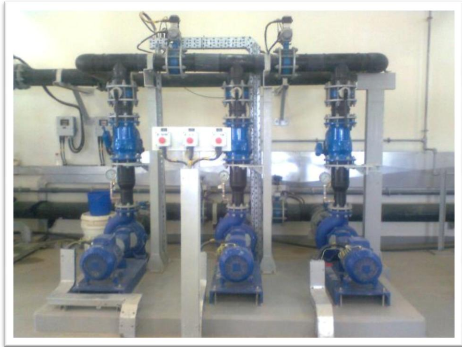
شكل رقم (10) يوضح المضخات التي تضخ المياه الناتجة من حوض التهوية لحوض التجميع
