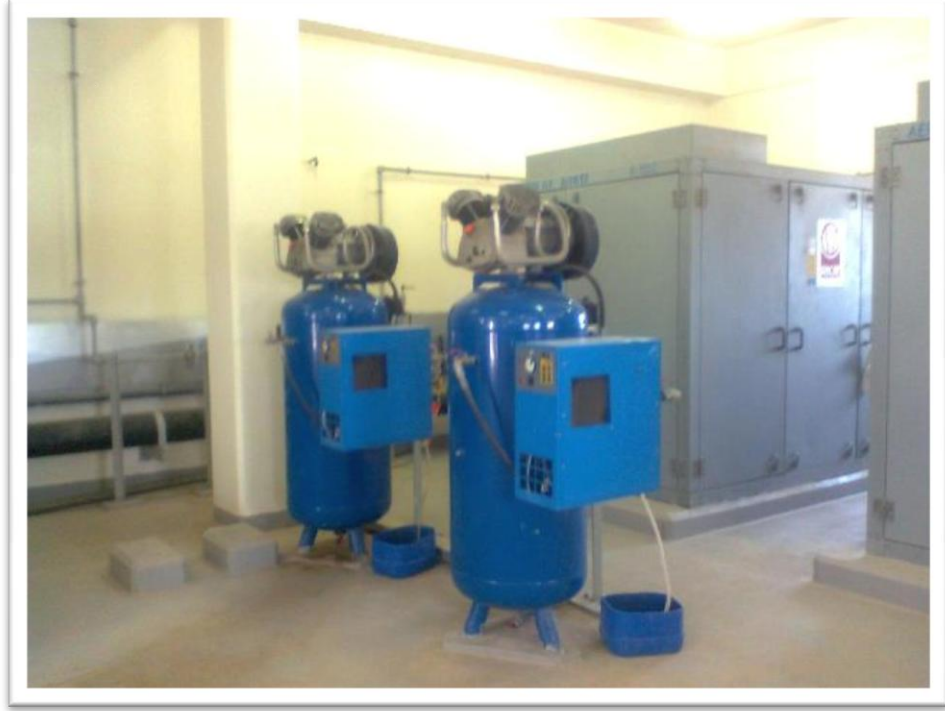
شكل رقم (9) يوضح مضخات الهواء الموجودة بغرفة الماكينات التي تضخ الهواء لحوض التهوية
