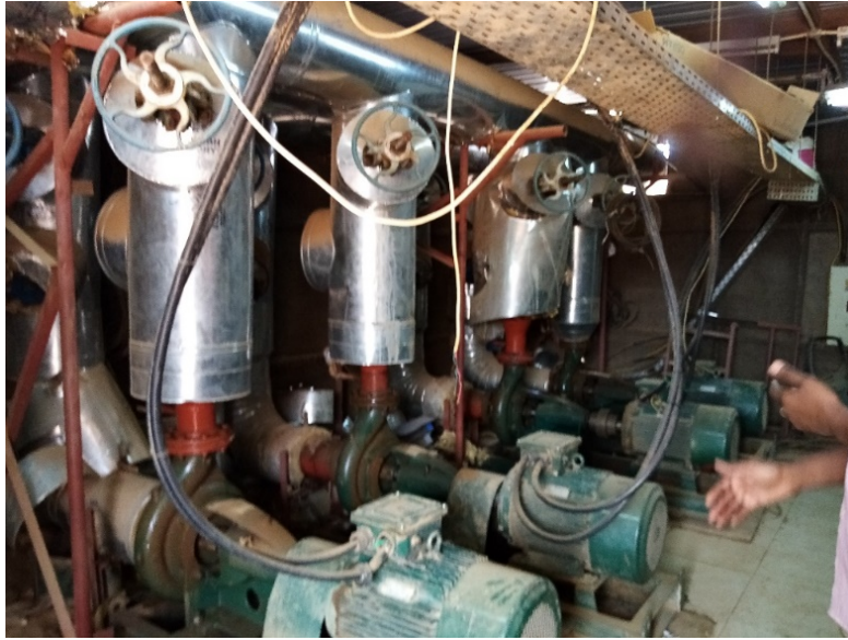
صورة 3-5 يوضح مضخات الطرد المركزي بمستشفى رويال كير.-المصدر:تصوير الباحثة
