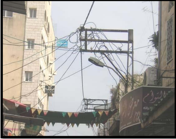
الصورة (22:5) مشاكل الأعمدة الكهربائية بحي البوستة
