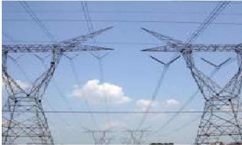
شكل رقم (2-4) ابراج نقل الكهرباء.
