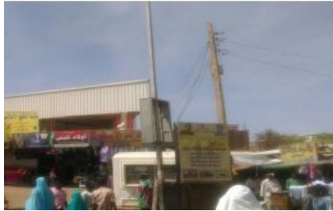
صورة رقم 39.1 توضح اسلاك الكهرباء السوق الشعبي الخرطوم
