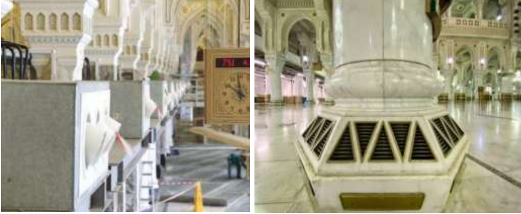
صورة رقم (37)توظيف الأعمدة في فتحات التكييف صورة رقم(38) توضح شكل آخر لفتحات التكييف الإضاءة:
