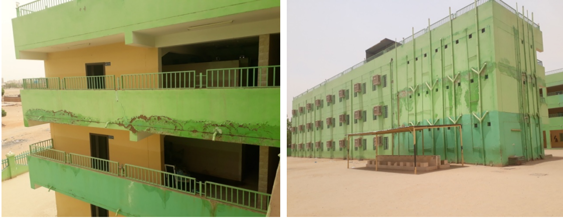
صورة (4-28) توضح مشكلة تسريب مواسير الصرف الصحي بالواجهة الرئيسية.
