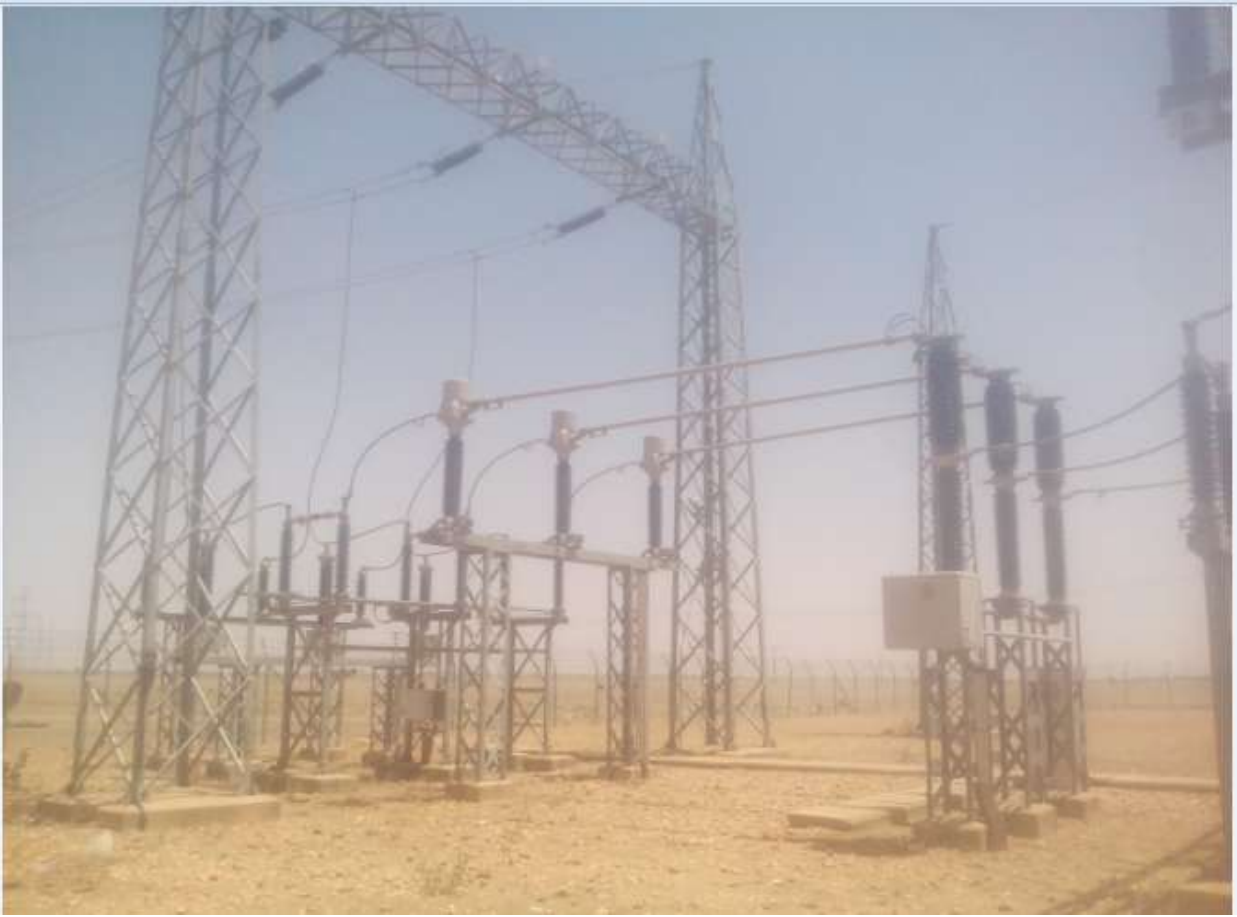
صورة توضح محول التيار ومحول الجهد والقواطع لمحطة المناقل التحويلية
