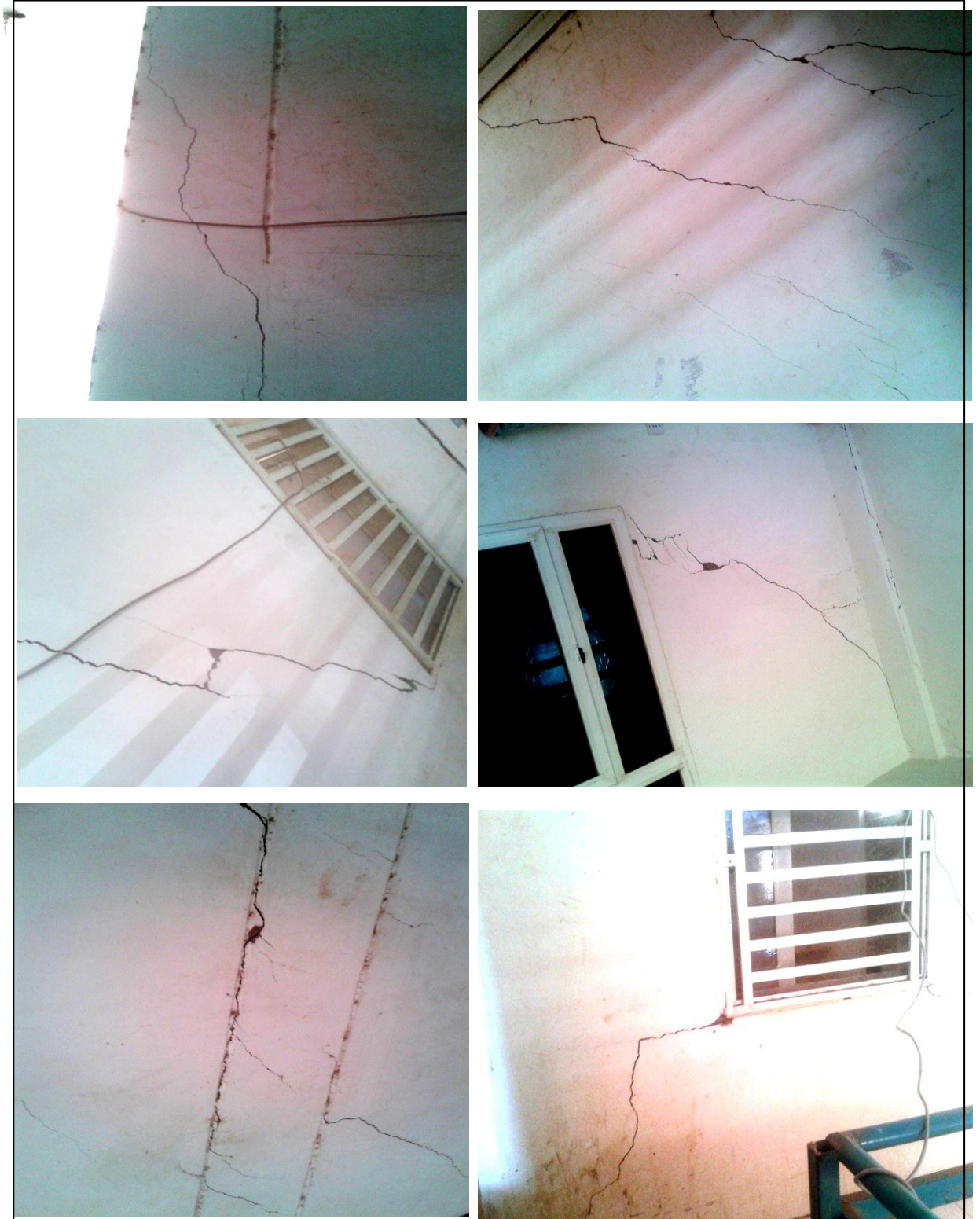
الشكل رقم (4-11) يوضح الشروخ في حوائط المبنى الداخلية
