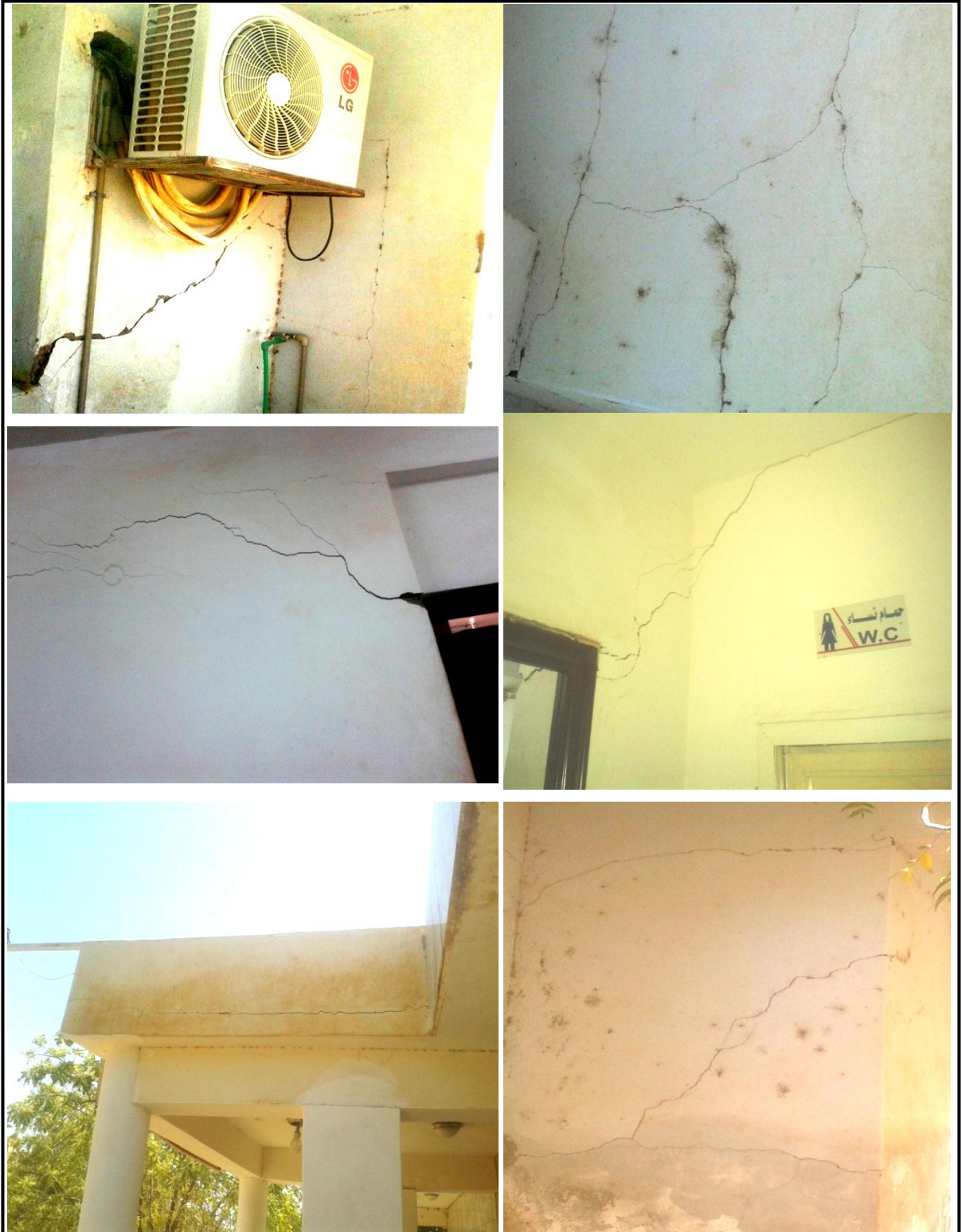
شكل رقم (4-6) يوضح الشروخ بمبنى مركز غسيل الكلى
