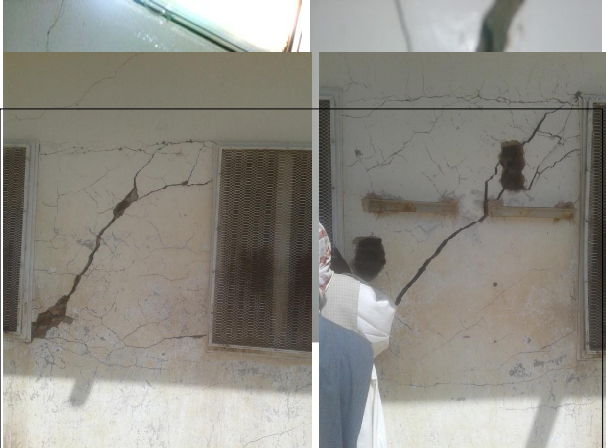
الشكل (3-4) يوضح الشروخ بحوائط المستشفى الداخلية
