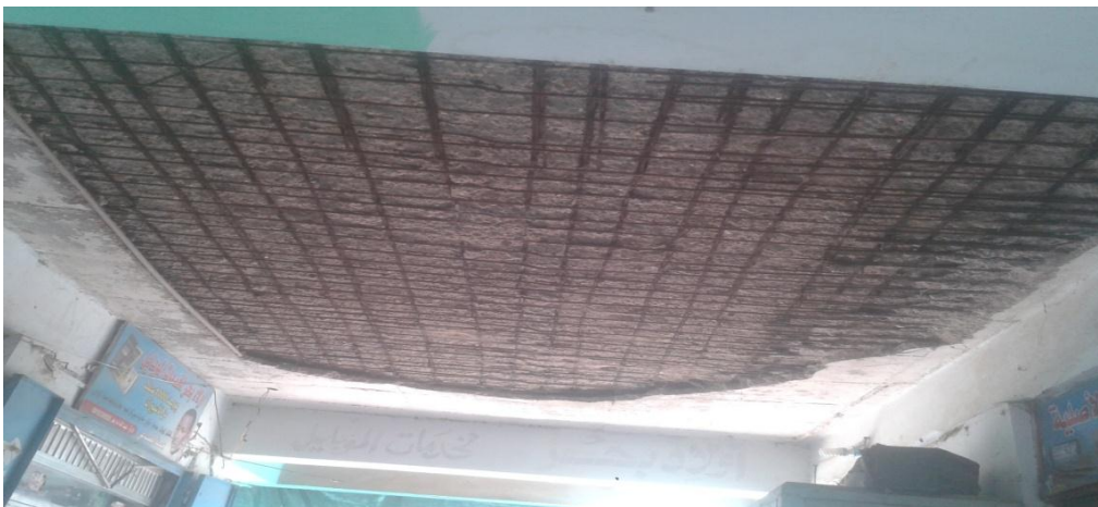
شكل رقم (4-13) يوضح انفصال الغطاء الخرساني بسقف المبنى
