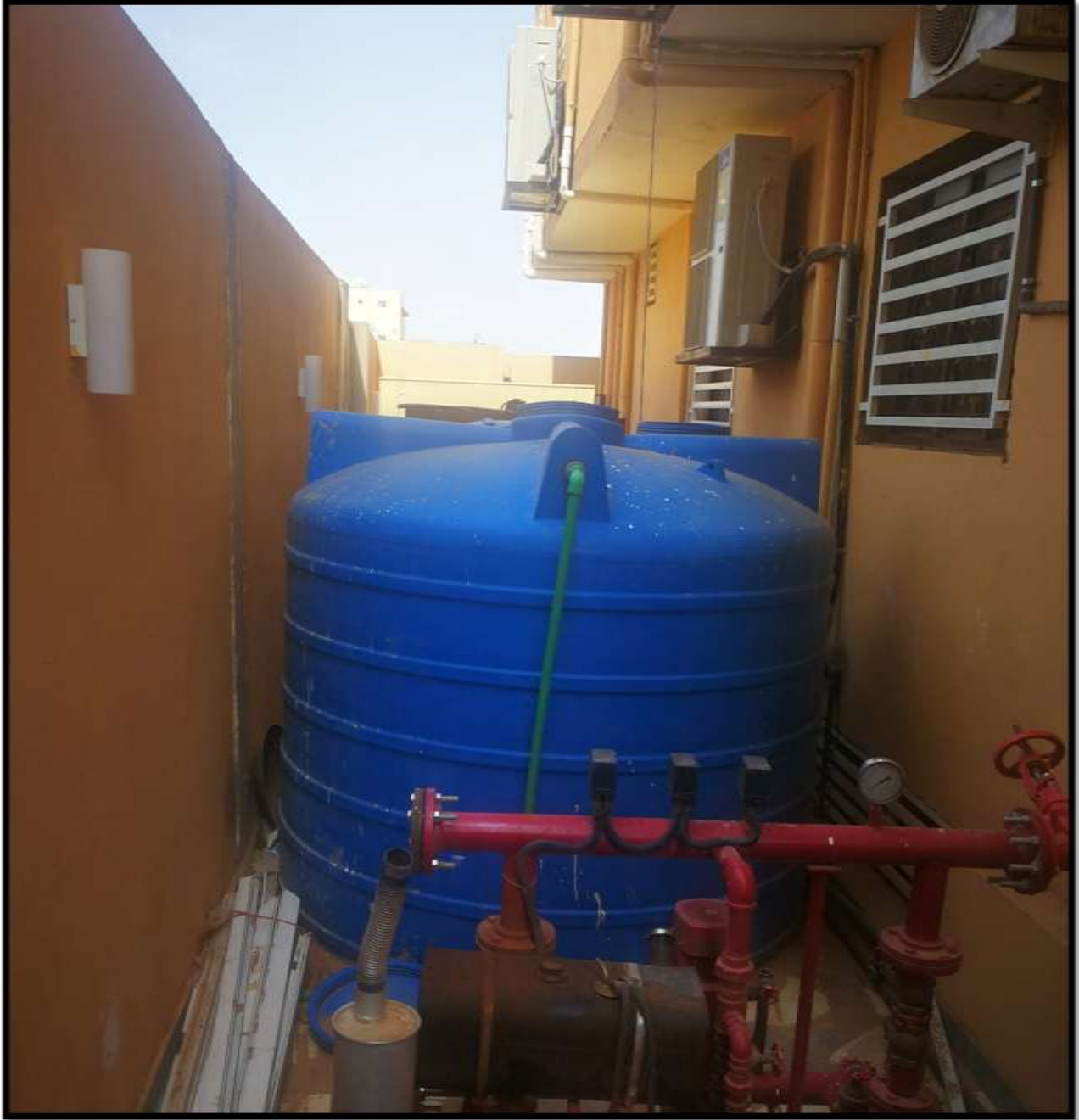
صورة (10-3): خزان المياه الأرضي للنموذج الثاني (المصدر: الباحث 2019)
