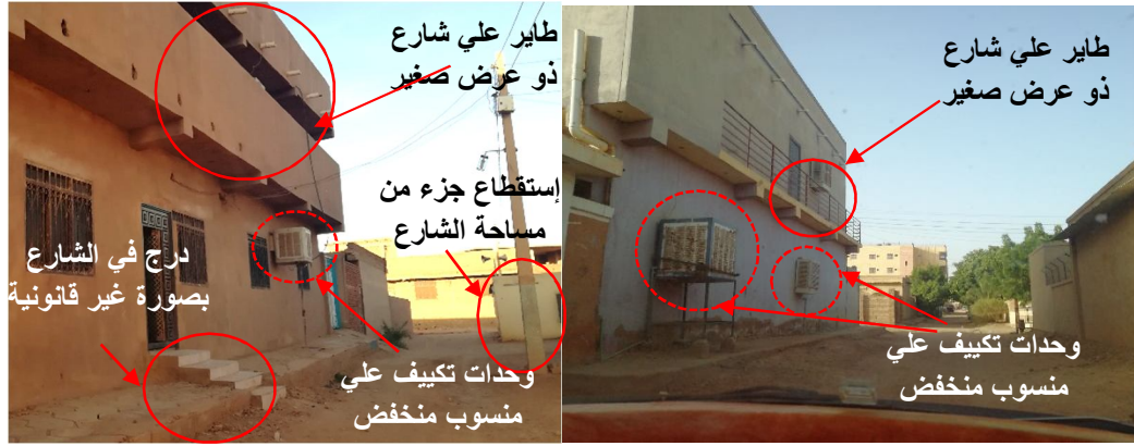
شكل (4-2-56) مخالفات تركيب وحدات تكييف علي ارتفاع أقل من القانوني (المصدر: الباحثة)
