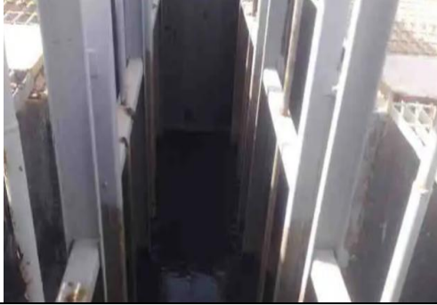
صورة (2-2) توضح احواض ترسيب الرمال (GRIT REMOVAL)
