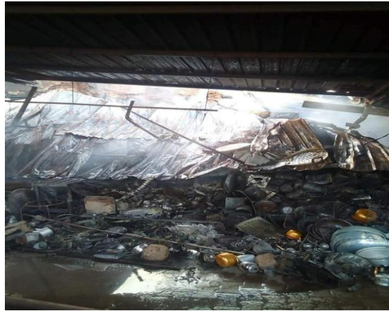
الصورة 4-20 حريق منطقة الدراسة
