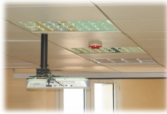
صورة رقم (2-4) توضح نظم الاضاءة والإطفاء لبرج الاتصالات - الخرطوم بري المصدر : الباحث
