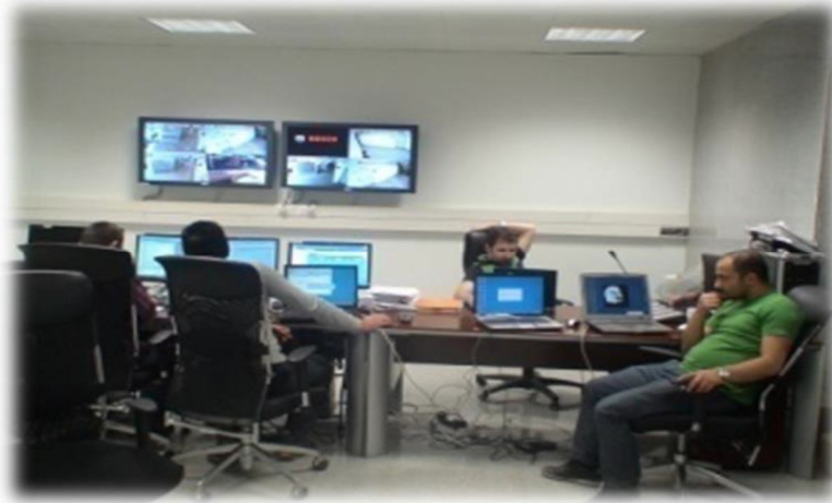
صورة رقم (3-4) توضح غرفة التحكم وإدارة المعلومات في برج الاتصالات - الخرطوم بري المصدر : الباحث
