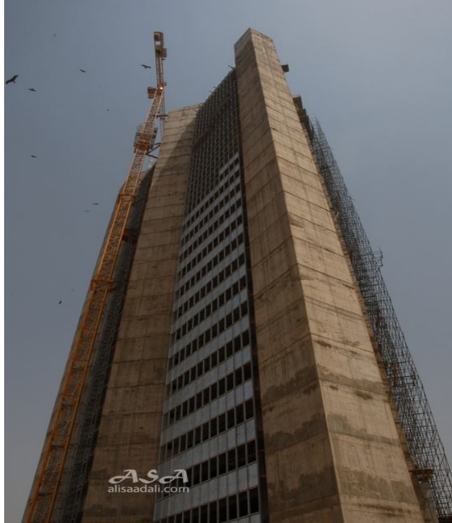
صورة رقم (4-4) توضح التشكيل الإنشائي الخرساني لبرج الاتصالات - الخرطوم بري المصدر www.alisaadali.com
