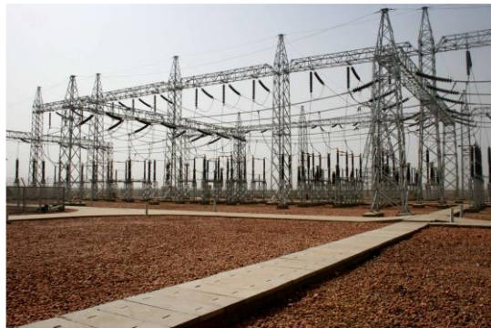
صورة (٥-٤) توضح محطة تحويلية - شركة النقل
