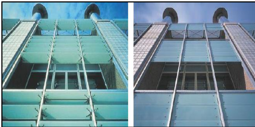
شكل (٣-٢١) يوضح تغير اتجاه الشرائح الزجاجية الدوارة حسب زاوية الاشعاع الشمسي المصدر: Wigginton and Harris 2002
