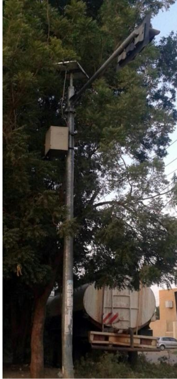
شكل رقم (3-100) إشارة مرور تعمل بالخلايا الشمسية ومربوط بغرفة الرقابة الالكترونية بواسطة كمره
