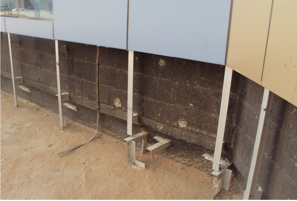
شكل رقم(3-11) يوضح عزل الحائط ضد الماء والرطوبة كما توضح قطاع الالمنيوم المستخدم في تركيب الواح الحشوة.
